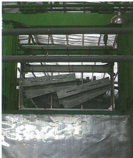
塗装前処理ではリン酸鉄と三価クロムの両方の処理槽を設置
